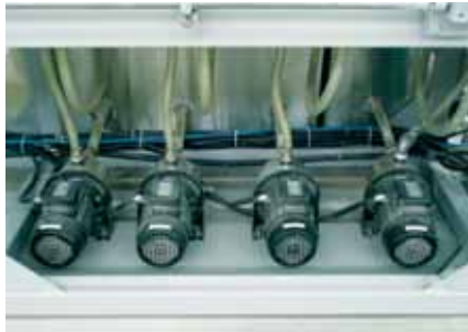
Edelstahl-Kreiselpumpen unterhalb der Waschzone, Wassertank mit Heizung, Füllstand-Sensor mit Kontroll-Lampe.
